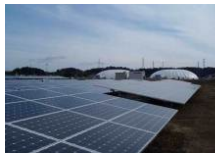
太陽光発電所(平成25年3月)
